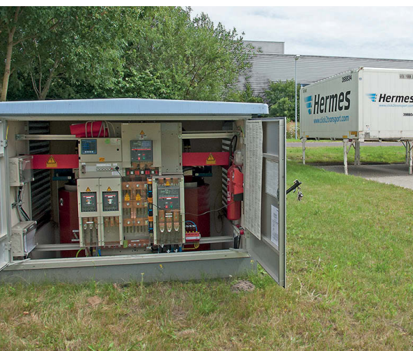
Die Trafostation von Hermes Fulfilment. Bildquellen: Janitza electronics GmbH und Hermes Fulfilment GmbH
