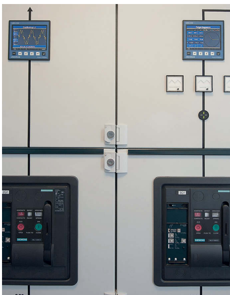
Janitza UMG 508 überwachen die Einspeisung.
