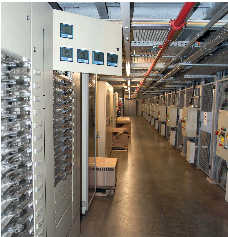
Die Stromversorgung für die automatisierten Fahrgassen (rechts im Bild). Der Energiebedarf einzelner Verbrauchergruppen wird getrennt erfasst.
