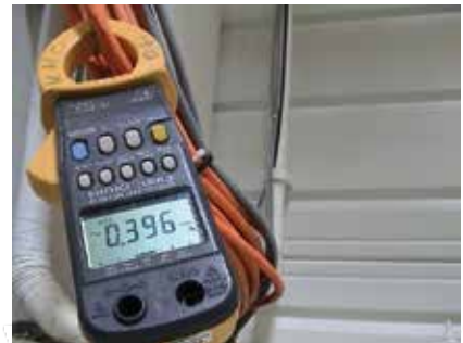
Abb.: Vermeidung von vagabundierenden Strömen auf Datenleitungen
