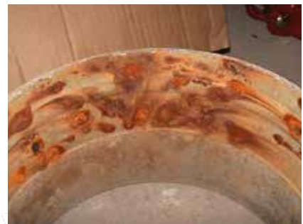
Abb.: Korrosionen von Rohrleitungen
