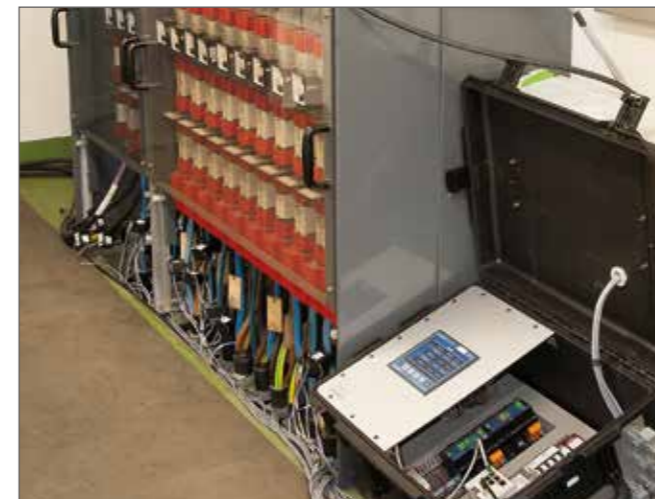
Bild 9: Die mobile Messbox neben einem Abgangsfeld. Die Klappwandler lassen sich ohne Eingriff am Leiteranschluss montieren und demontieren. Das macht den mobilen Einsatz erst möglich.
