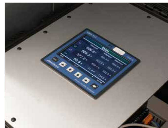
Bild 4: Wie die Messwertspeicherung zeigt, ist der überwachte Abgang gut ausgelastet. Der Nennstrom beträgt 1000A, die Phase L2 wurde zeitweise mit 933 A belastet.
