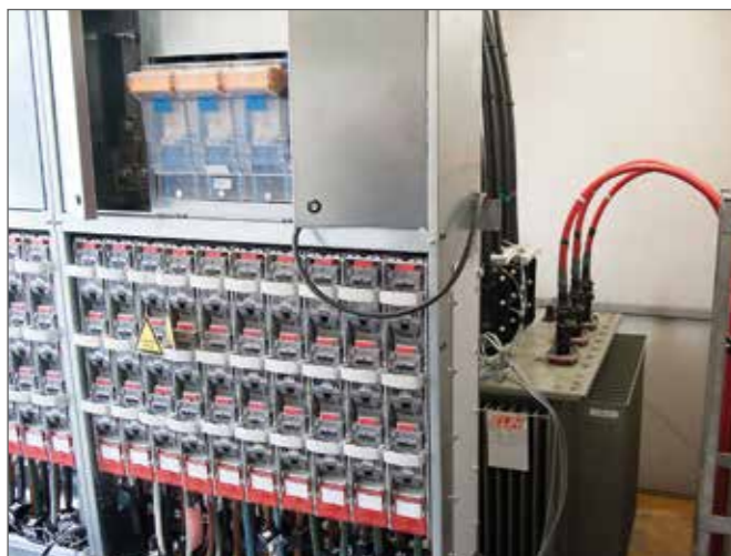
Bild 7: Die Wandler sind sowohl an den Abgängen als auch an den Zuleitungen vom Trafo installiert. So erhält man ein vollständiges Bild der gesamten Situation.
